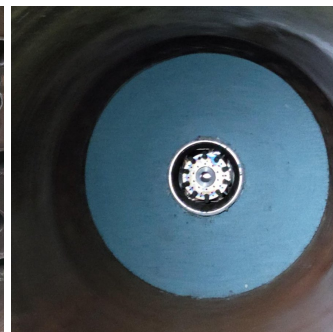
Vue du foyer vers le brûleur
